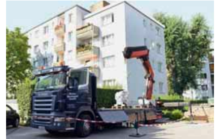
Die Installation des GASAG-Klimakraftwerks erfolgte durch den SHK-Fachbetrieb Alpro.
